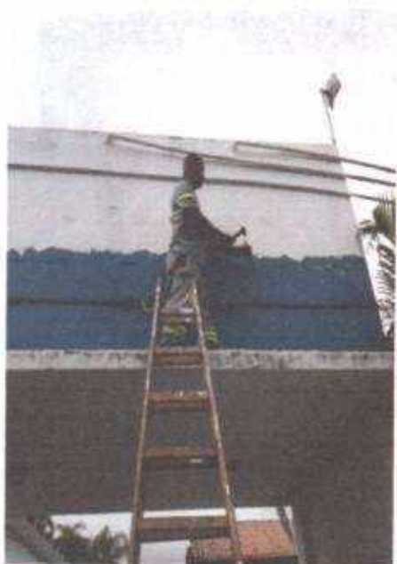
Pinturas no na fachada do abrigo
