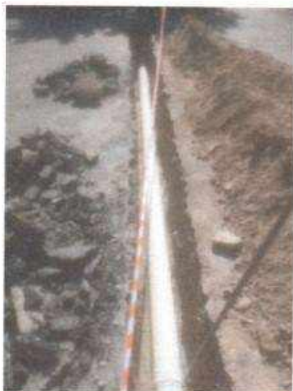
Drenagem de águas fluviais
